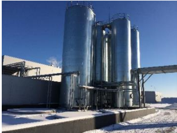
Резервуарный парк базового масла
