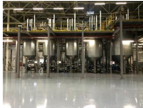
Станция периодического смешивания
