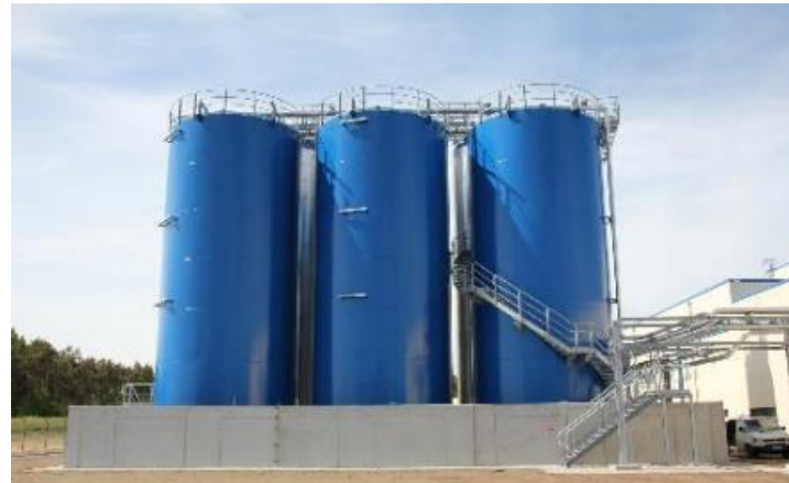
Резервуарный парк базового масла
